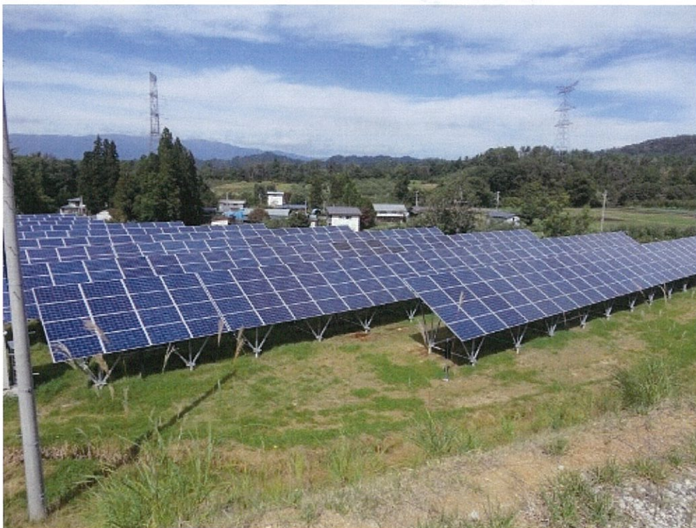
図8●やまがた新電力に売電する「長井第2おひさま発電所」(出所:日経BP)
