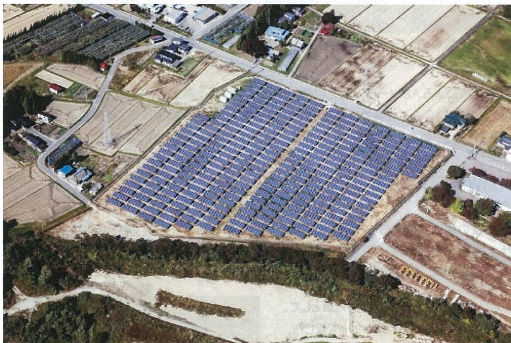
図1●「長井おひさま発電所」の全景（出所：東北おひさま発電）
